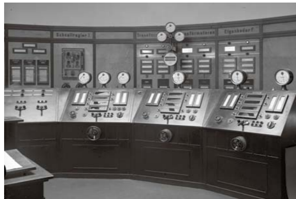
Die Schaltwarte des Kraftwerks
