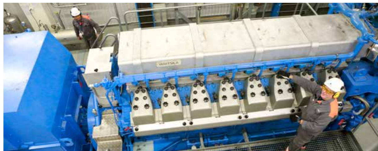
En ny gemensam reservkraftdiesel för R3 och R4 togs i drift.
