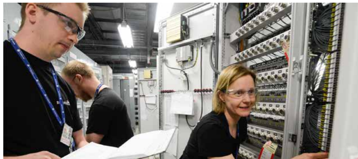
Ställverk och cirka 600 automatsäkringar byttes i relärummen under revisionen, samtidigt som bättre fysisk separation infördes för säkerhetsklassade objekt.
