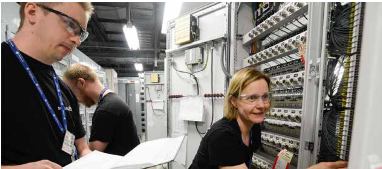
Ställverk och cirka 600 automatsäkringar byttes i relärummen under revisionen, samtidigt som bättre fysisk separation infördes för säkerhetsklassade objekt.
