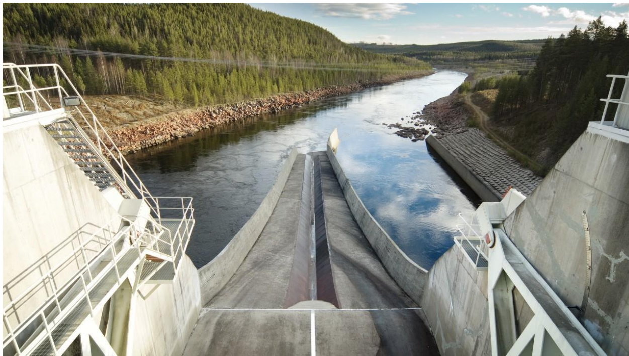
Tuggens kraftstation, Umeälven
