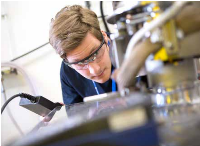
Med hjälp av mekaniserade svetsmaskiner kan Ringhals göra många verkstadsjobb i egen regi. Daniel Oskarsson övervakar svetsningen på en av de många delar som prefabricerats inför årets revision på Ringhals 2.
