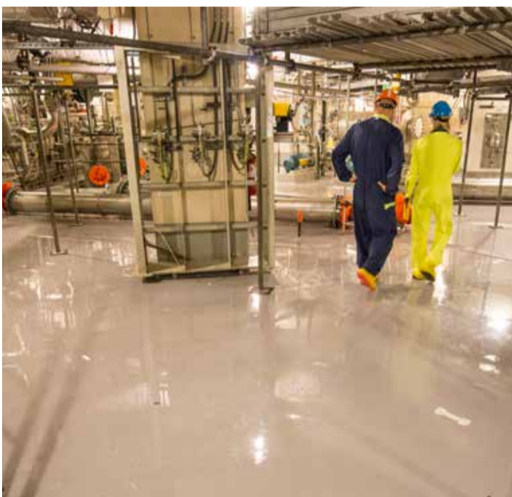
Det nya golvet i reaktorinneslutningen är blankt som ett dansgolv och lätt att hålla rent efter den avslutande målningen.
