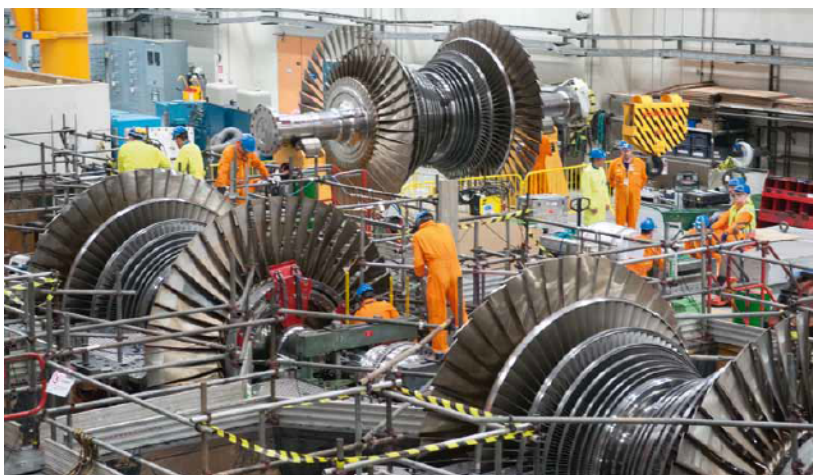
Byte av LT-turbin på R1 2012
